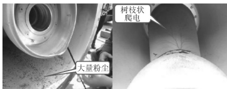
图6 套管户外部分短尾端电容屏表面的树枝状爬电现象
